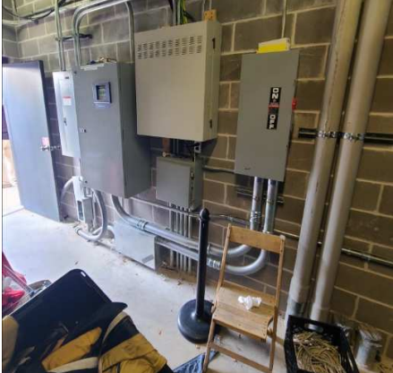
Existing AV room electrical distribution
